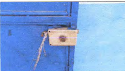
FOTO 5: Sustrucción de chapa EN COCINA
